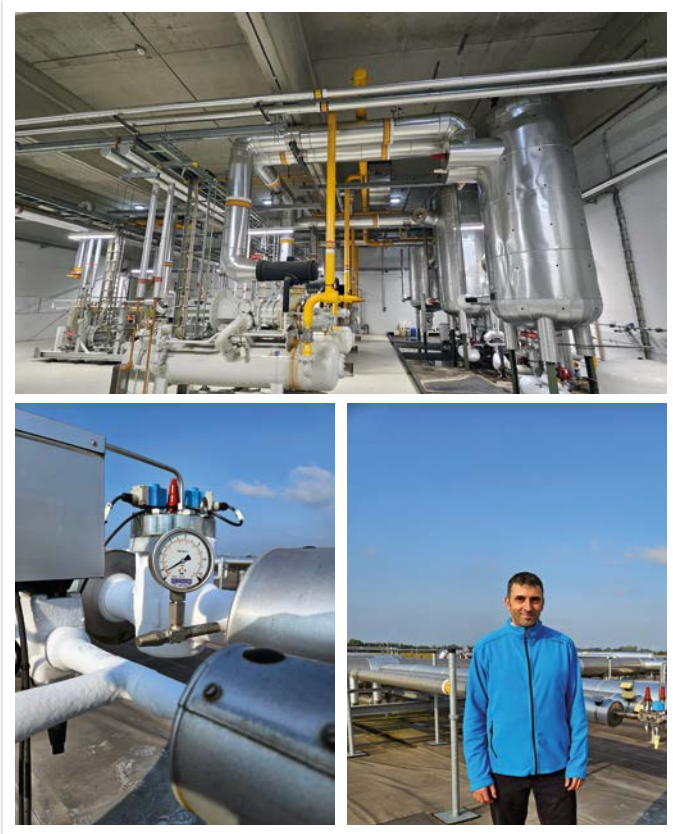
Abbildung 1: Kälteanlage in einem norddeutschen Logistikzentrum
